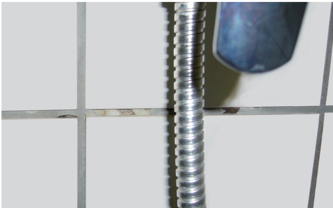
Abbildung 1: Geschädigte Zementfugen im Duschbereich: Eine unangenehme Folge moderner Haushaltsreiniger
